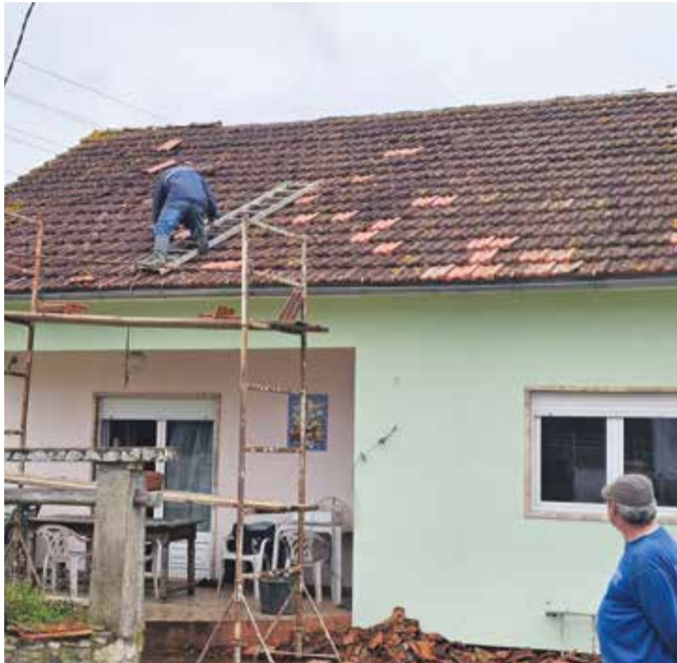
●Abílio Ferreira, de 80 anos, a reparar a casa de um familiar, na aldeia de Casalinho, freguesia de Pombal, também a sua casa ficou parcialmente destruída: "40.000 euros não me chegam para as reparações", conta
