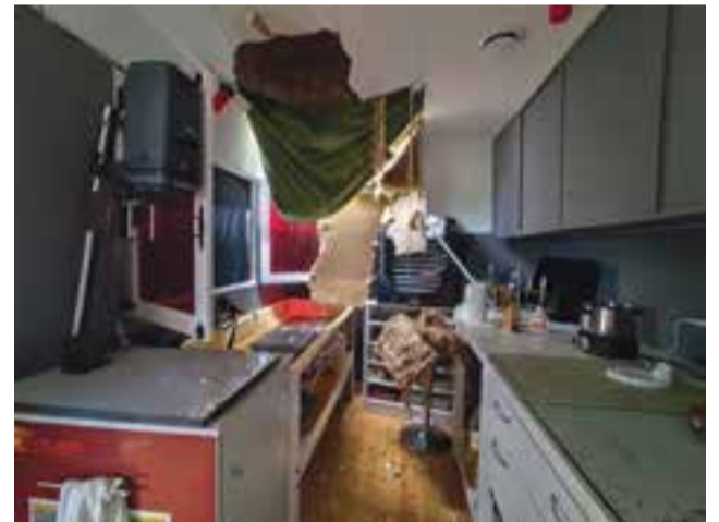
● Além dos estragos na habitação, Telmo Mendes perdeu o local de trabalho
