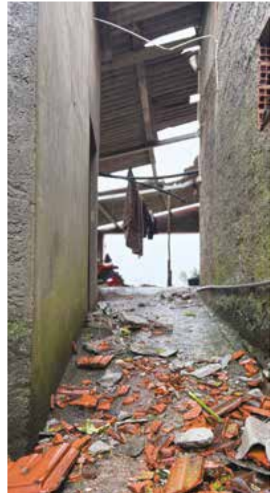
•Na freguesia de Abiul, casas e anexos, ficaram sem telhado, sem luz e sem água por um período que superou os 12 dias
